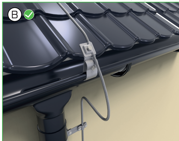
przewodzenie przewodu nad rynną
